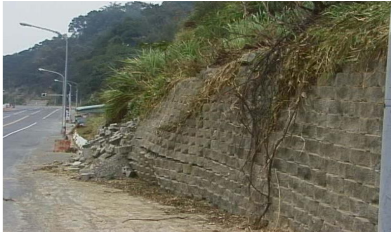
Figura 1. Daños del muro reforzado con geosintéticos después del terremoto Chi Chi, Taiwan, 1999 (Koseki and Hayano et al. 2000).
